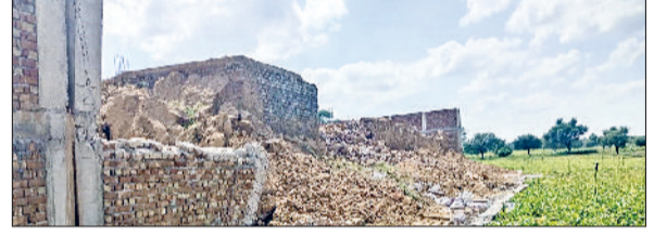
बाढ़ड़ा। निर्माणाधीन उपमंडल भवन की गिरी चारदीवारी। फोटो: हरिभूमि
